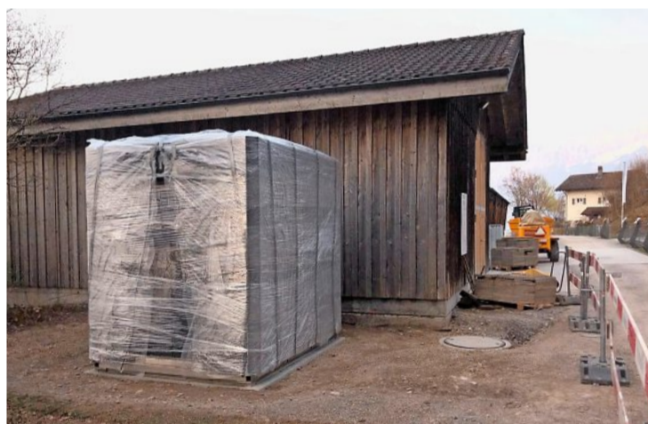
Noch in Schutzfolie gehüllt: Die WC-Anlage beim Bootshaus. Die selbstreinigende Toilette aus Chromstahl ist ein Fabrikat aus Zürich.
