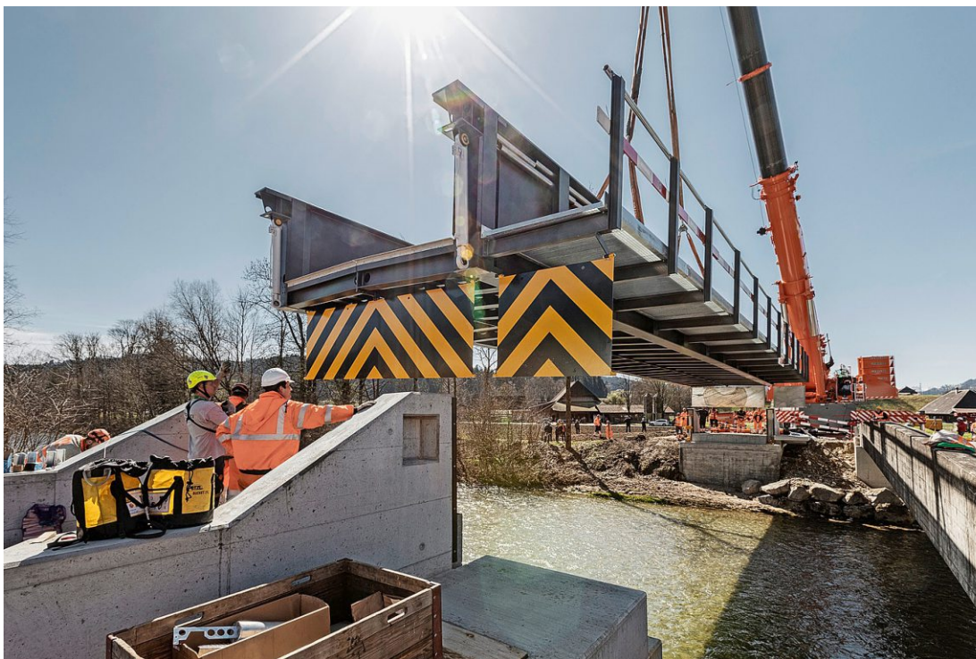
Beim Setzen der neuen Stahlbrücke war gestern Sonntag Präzisionsarbeit gefragt. Die alte Betonbrücke rechts im Bild wird Anfang Mai abgerissen. Foto: Brigitte Mathys
