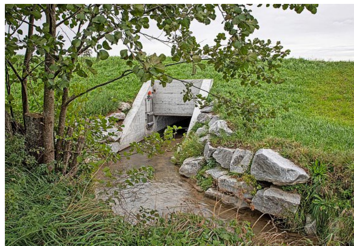
Bereits im Herbst 2019 fertiggestellt: Der Damm in Bollodingen. Das Hochwasser dieses Jahr war der erste richtige Stresstest für die Anlage.
