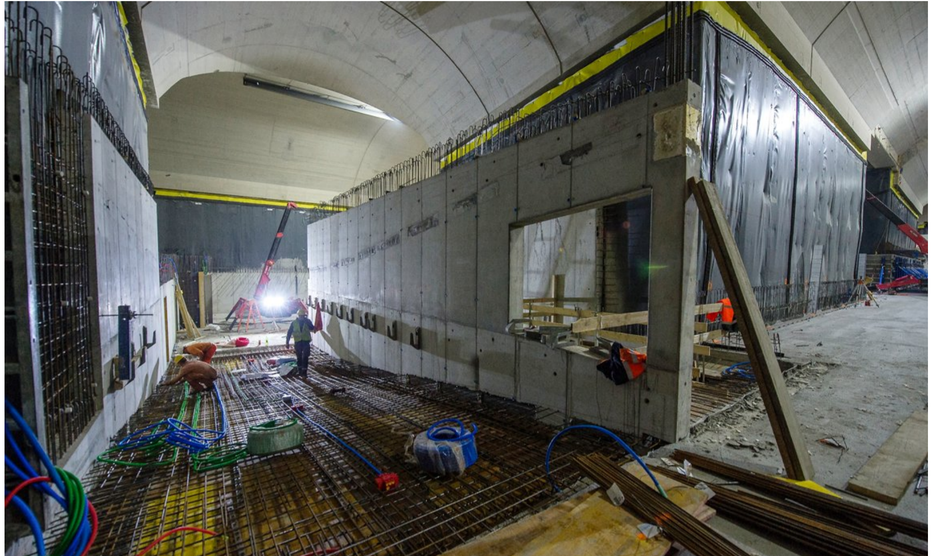
Diese Rampe, für die hier die Armierung verlegt wird, führt von der Burgstrasse-seitigen in die um ein Halbgeschoss tiefer liegende Hauptgasse-seitige Kaverne.
